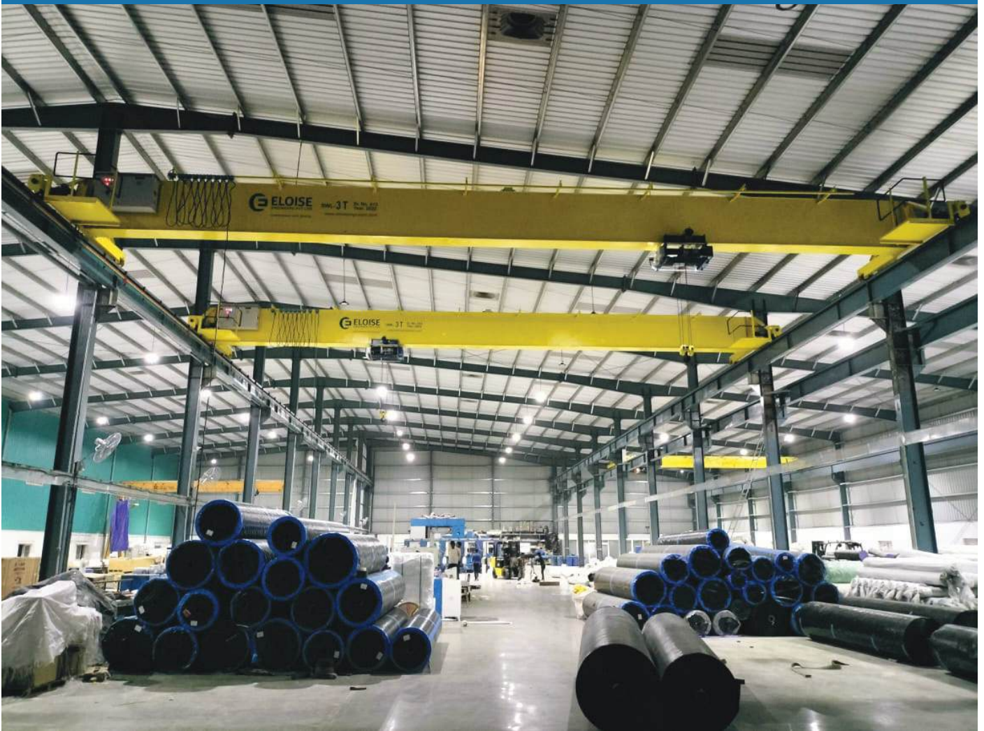
3 Ton DG EOT
